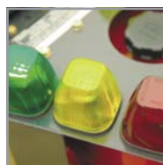
Überlastwarnlampen + Notstop + Alarm
